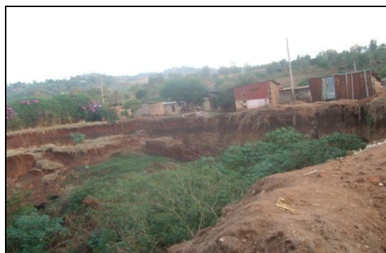
Photo 2: Glissements de terrains qui menacent la destruction des maisons à Kumugoboka (Quartier Est de la Ville de Bujumbura).
