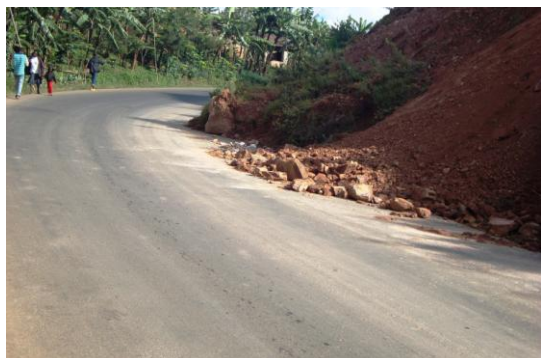
Photo1: Glissements de terrains sur la RN1.
